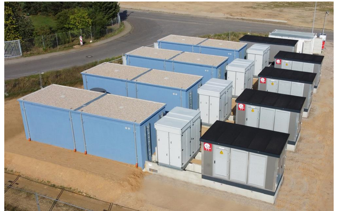
Et af Obtons batterilagere i drift i Tyskland.
