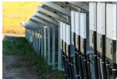
Invertere placeret under solpaneler
